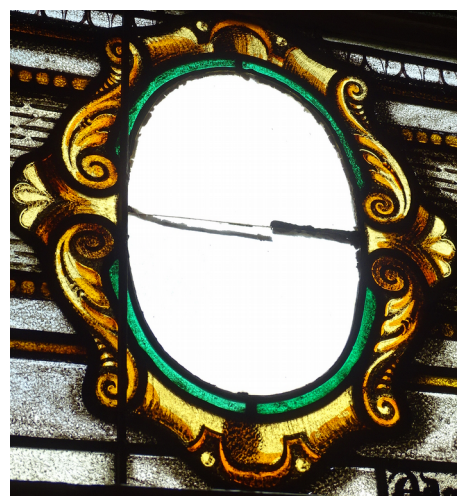
fot. 6: wtórnie uzupełnione szklenie w miejscu herbu w lewym kartuszu; widoczne łączenie dwóch odrębnych tafli w stanowiącym pierwotnie jedną całość otoku
