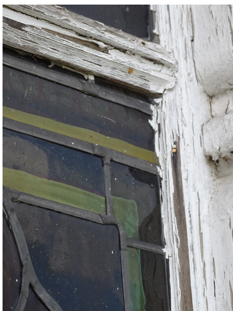
fot. 3: fragment ramy okiennej ze szprosem zagłębionym pod wtórnym listwowaniem; widoczny zły stan warstwy malarskiej i wtórne zamalowania na szkleniach
