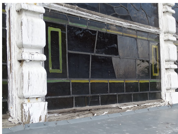
fot. 4: zdegradowana dolna część ramy okiennej i nieprawidłowe wykonanie blaszanego parapetu, z nachodzeniem na ramę i pozostawieniem szczeliny, którą wpływa pod spód woda opadowa, widoczne architektoniczne formy słupków
