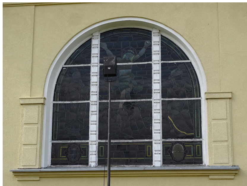
fot. 2: widok witraża i stolarki okna z zewnątrz, widoczne ugięcia szprosów przenoszące ciężar górnych kwater w postaci naprężeń na kwatery poniżej
