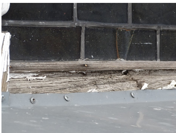
fot. 5: pęknięta szybka w dolnej kwaterze; zdegradowana dolna część ramy okiennej i nieprawidłowe wykonanie blaszanego parapetu, z nachodzeniem na ramę i pozostawieniem szczeliny, którą wpływa pod spód woda opadowa
