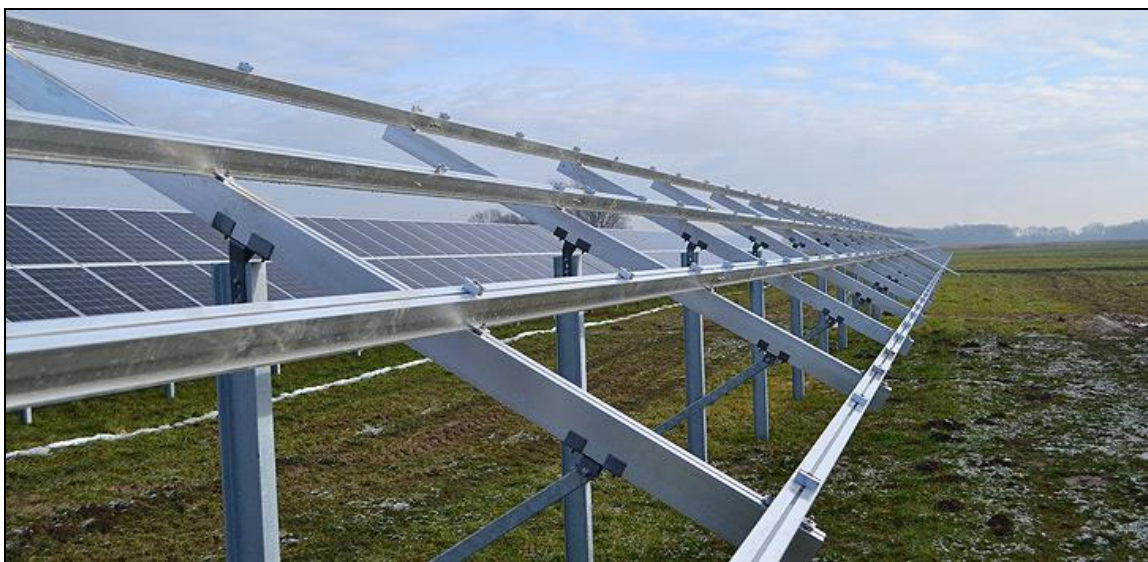
Fot. 7. Konstrukcja przeznaczona do posadowienia paneli fotowoltaicznych (fotografia z zasobów inwestora).
